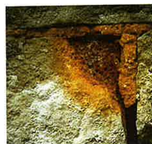
Incompatibilité entre un crépi mal adapté et un mur en tuffeau
