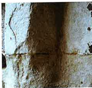
Altération par dégradation pulvérulente du tuffeau
