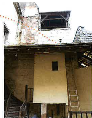
Parcelle AR 170. Les constructions ajoutées présentent un danger évident
