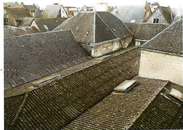
Parcelle AR 165. Les toitures de la superette s'insèrent brutalement dans le tissu existant et occupent toute la parcelle.
