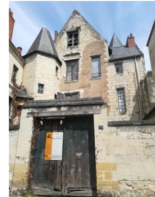
Rue Voltaire Vacance structurelle d'un bâtiment à haute valeur patrimoniale, en rénovation
